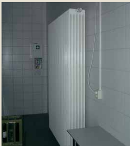
De radiatoren zijn dankzij hun extra groot contactoppervlak aangepast aan het warmteconcept op lage temperatuur. Foto Guy Dries
