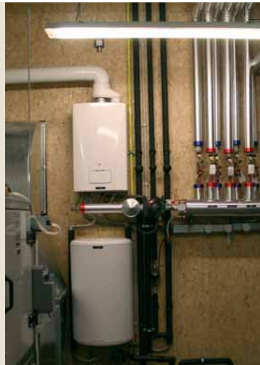
In de technische berging staan de miniaturverwarmingsetel (bovenaan) en -boiler (onderaan). Foto's VIBE vzw
