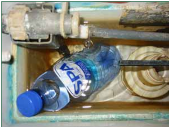
Door een fles in het spoelreservoir te leggen, kan je al heel wat water besparen.
