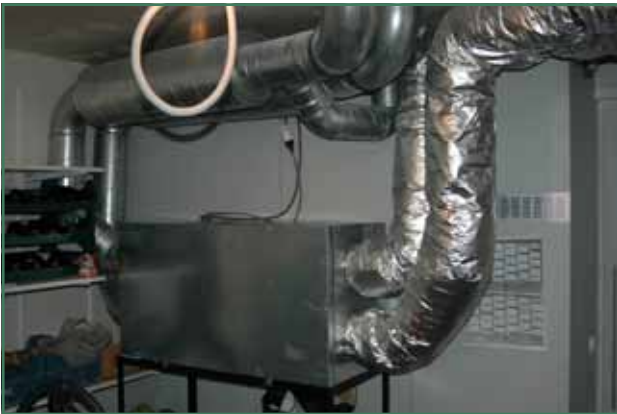
Ventilatiesysteem Bron: Stroomop
